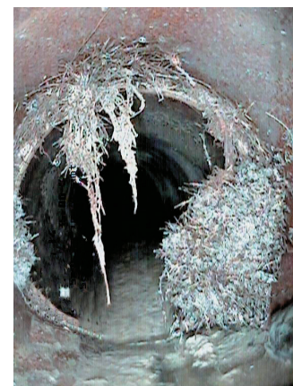
Bild 3: Wurzeleinwuchs im Kanal
