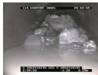
Kanalschaden durch Scherbenbildung - dadurch Kieseinbruch.
