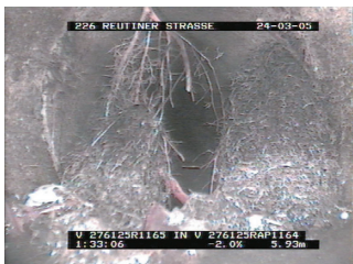
Bild 1: Kanalschaden durch Wurzeleinwuchs.
